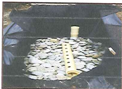
FOTOGRAFIA 5. Lecho Filtrante para el sistema de tratamiento de aguas servidas del pozo séptico.
