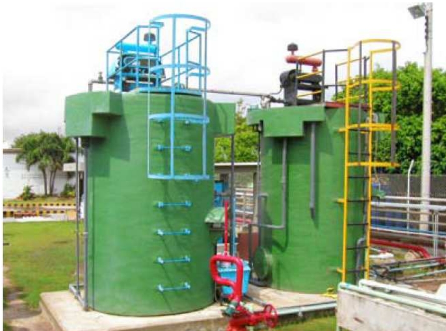
Foto 20 Sistema de tratamiento de aguas residuales domésticas similar al que será instalado en la planta de CEMCOLSA
