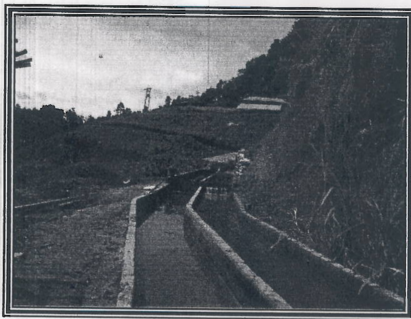
Fotografía 4. Tanques de sedimentación dispuestos en serie y en escala.
