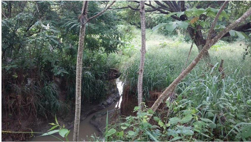
Figura 7.1. Muro roto del humedal Chicualí
