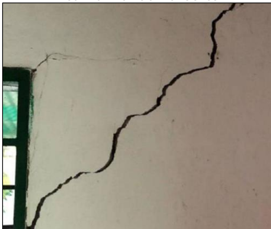
FIGURA 3 AFECTACIÓN POR SISMOS
